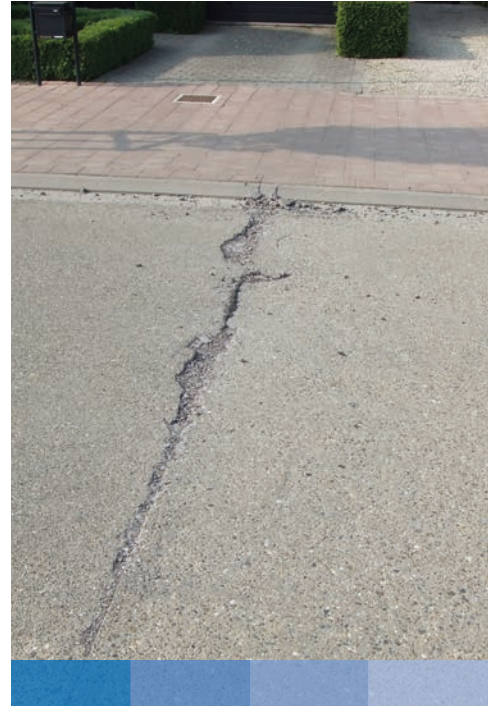
Genleřme derzinde k t  konumlandırılmıř dolgu malzemesinden kaynaklanan derz kırıkları
