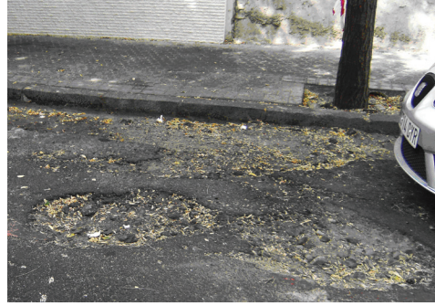
Şekil 12: Otomobil yangınında, kaldırımda meydana gelen hasar
