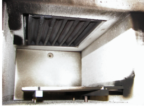
(c) Fırının iç üst kısmındaki kızılötesi ısıtıcılar
